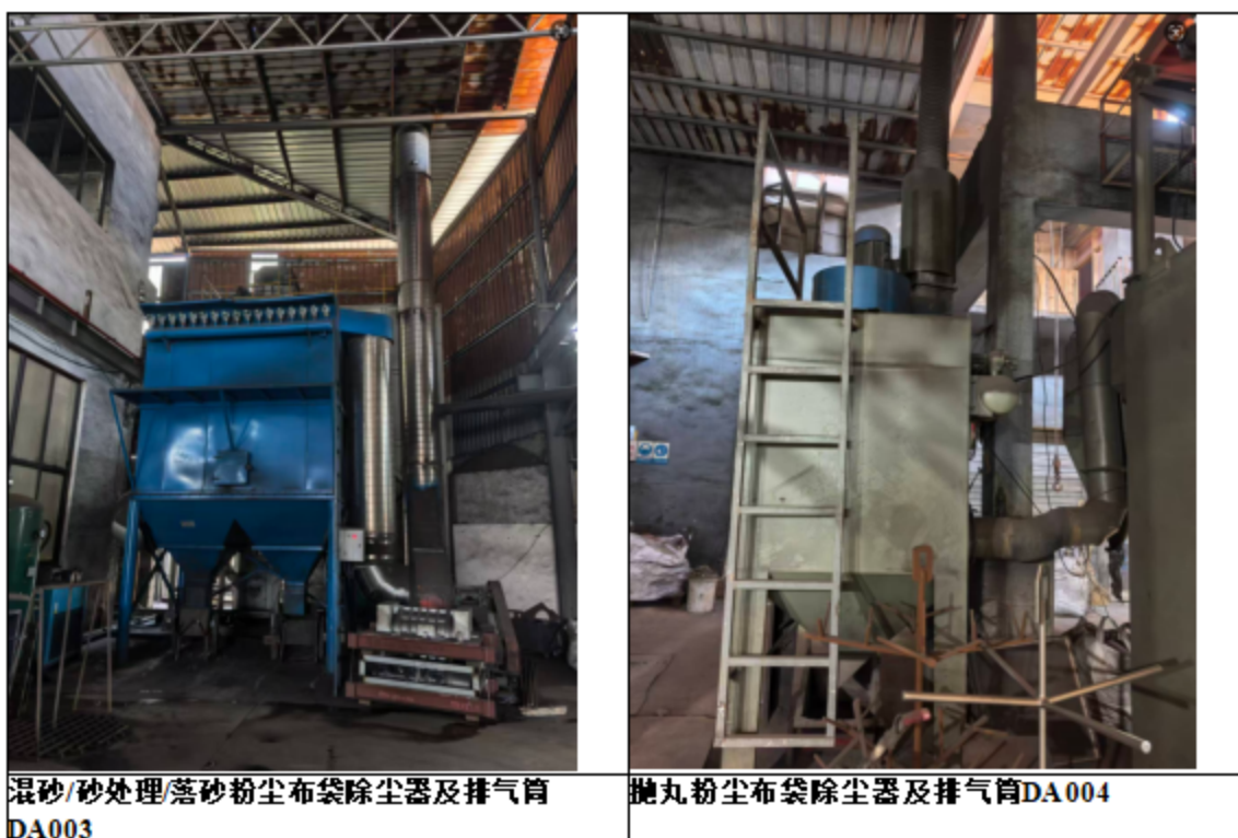
图4.2 废气处理设施照片
