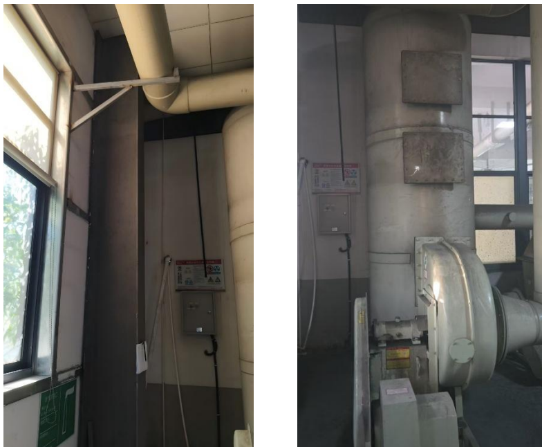
图 4.1-4 移印废气治理设施
