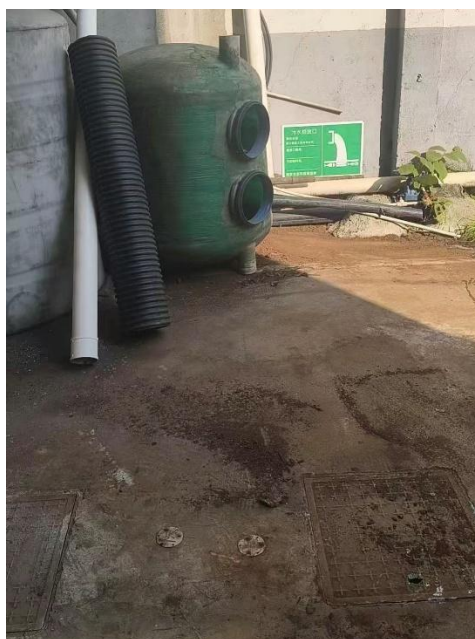
图 4.1-1 生活污水排放口
