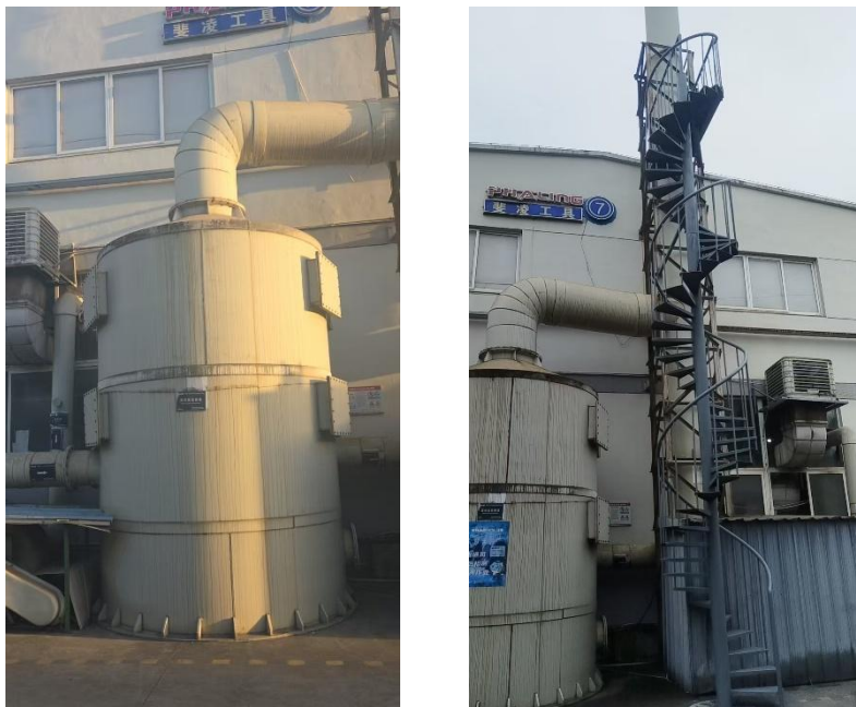
图 4.1-5 注塑废气治理设施
